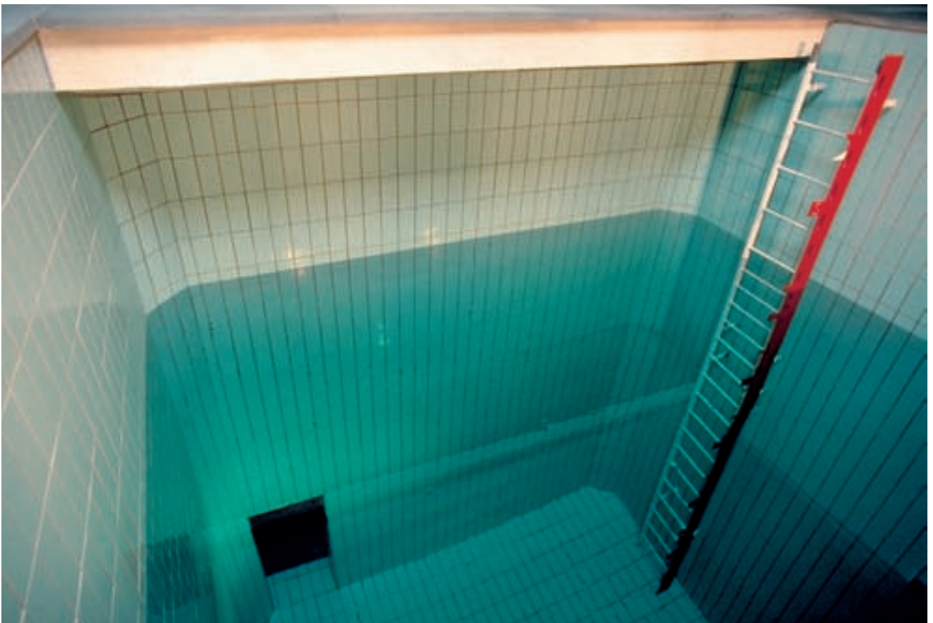
Einlaufkammer Zentrale West
